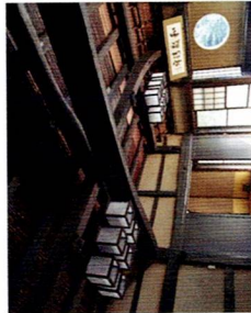
十字梁とチヨナナ梁(非公開) 画像提供：金鳳山平林寺 建物の中央をチヨナナ(手倉)梁で十字に組むことで、柱を省略して天井を高くすることができ、より広い空間を確保しています。
